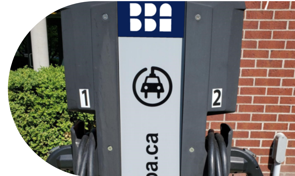
Bornes de recharge à Mont-Saint-Hilaire
